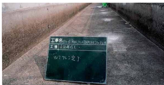
超高圧水ケレン
