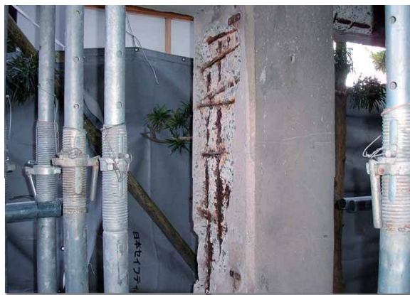
柱の劣化状況
