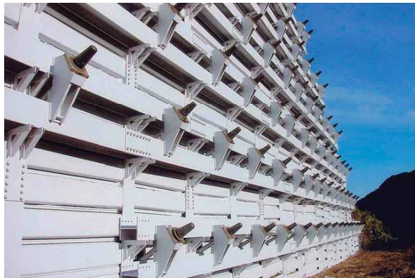
【のり面補強鋼材の防錆】
